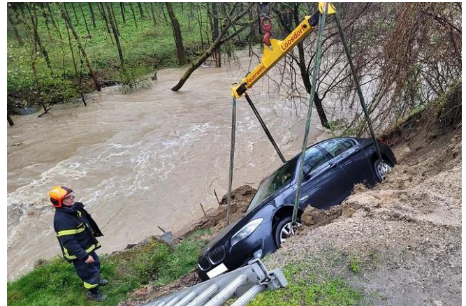
Das Erdreich unter einem abgestellten PKW gab nach
