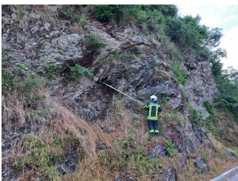
Felsteile auf Fahrbahn in Spielberg
