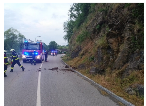
Felsteile auf Fahrbahn in Spielberg
