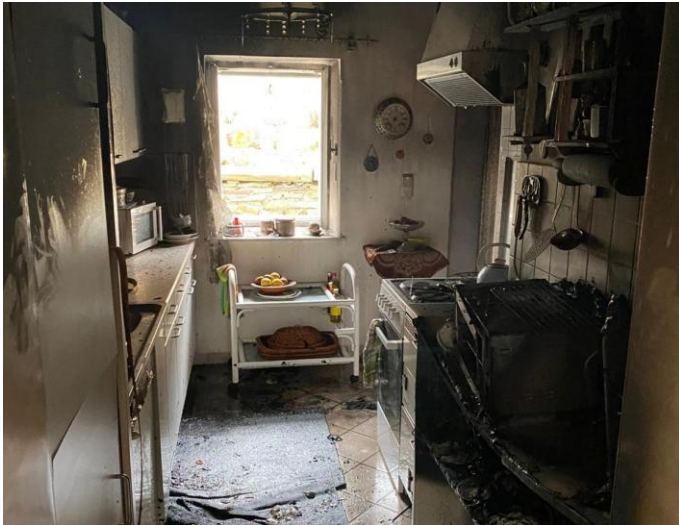
betroffene Küche stark verrußt
