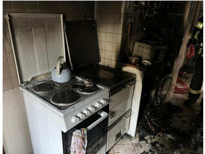
stark beschädigtes Inventar
